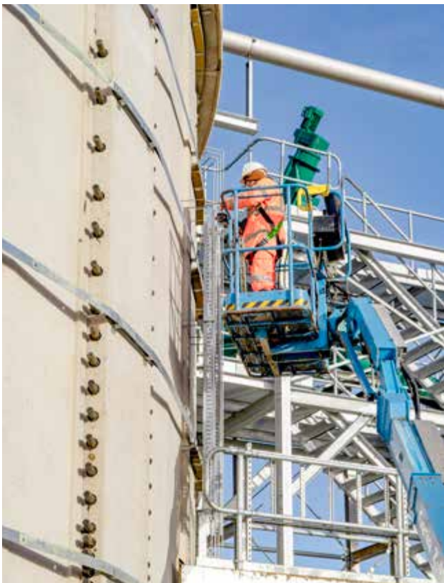
Noch fehlt die Verkleidung, Arbeiten an einem der Fermenter von Mepal III.
