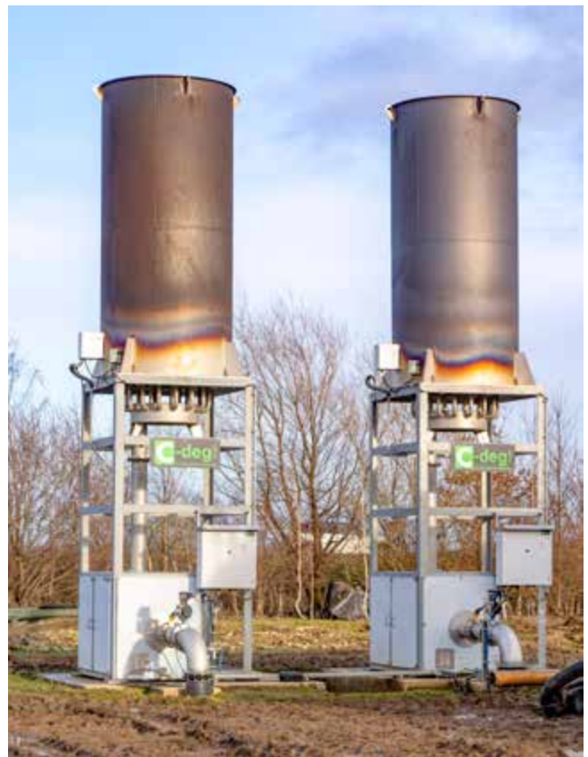
Die Größe der Gasfackeln verdeutlicht die Dimension der Anlage.
