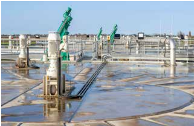
Die von Agraferm konzipierten Paddelrührwerke arbeiten mit niedrigen Umdrehungen, das spart Energie und reduziert den Verschleiß.
