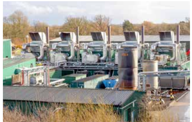
Nur bei Mepal I erzeugen Generatoren elektrische Energie.
